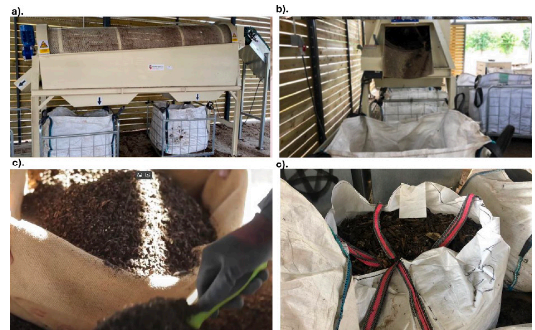
Figura 3.22. Tromel. (a) Vista del tromel y sus salidas laterales para el compost, (b) Salida trasera del estructurante, (c) compost fino tamizado (b) estructurante almacenado en big bag para reintegrar en el proceso. Adaptado DECOST (2021)
