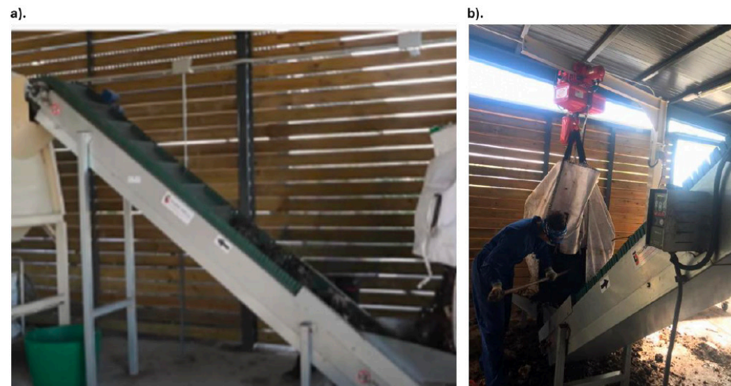
Figura 3.21. Cinta transportadora. (a) vista de la cinta transportadora, (b) Proceso de descarga del big bag hacia la tolva de alimentación de la cinta transportadora. Adaptado de DECOST (2021)
